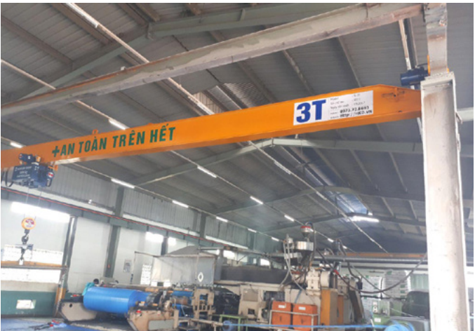
Cầu trục 3 tầng
