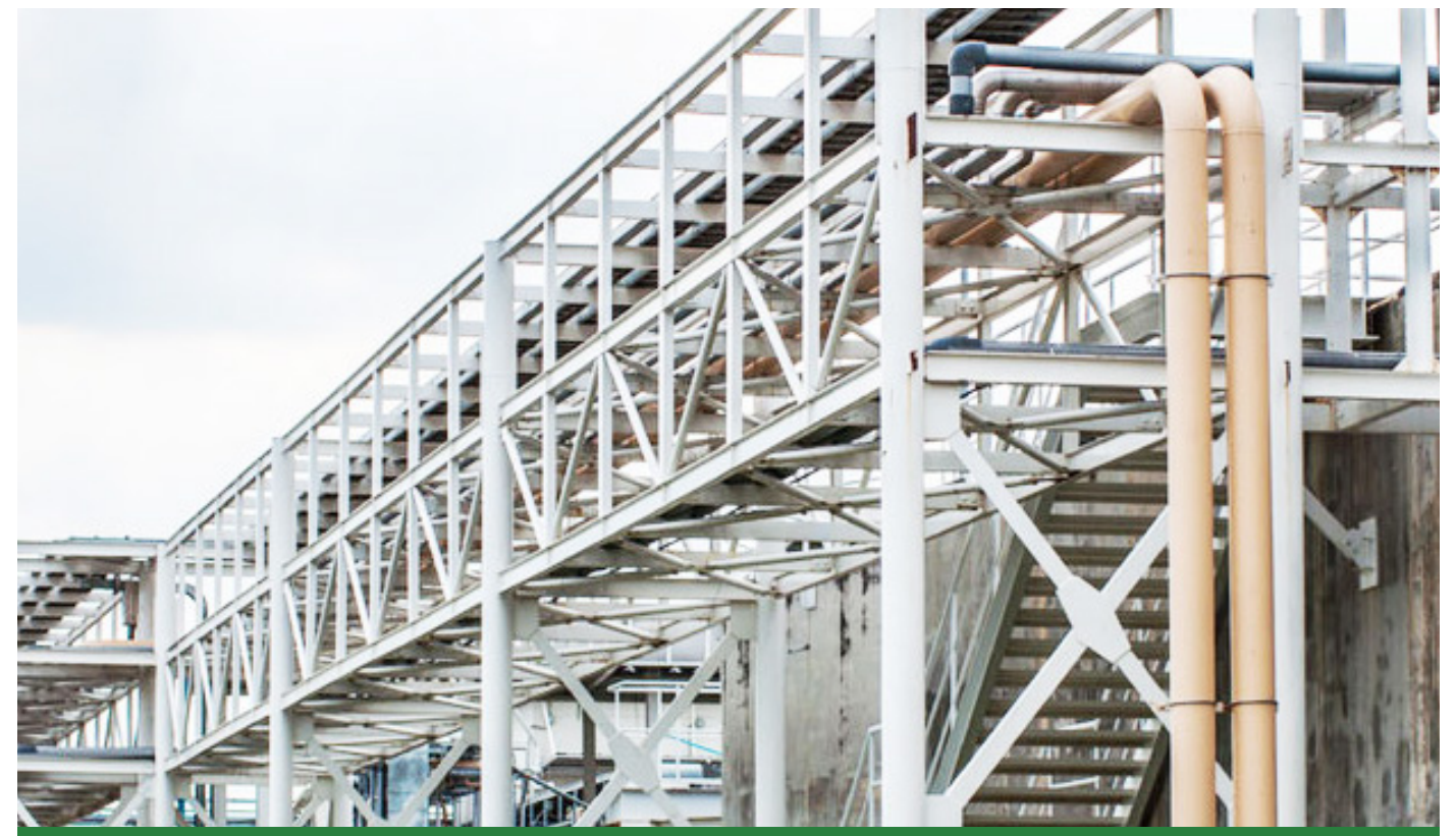
Hệ thống Pipe - Rack
